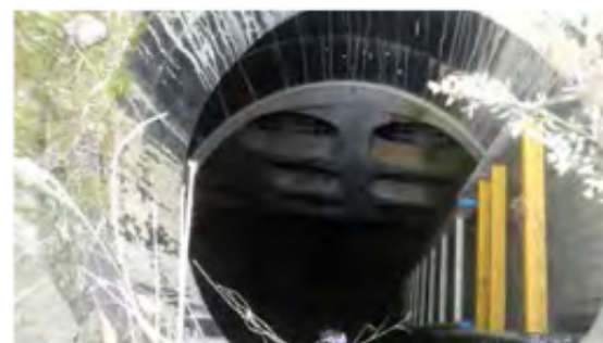
Ouvrage enterré Europe - Brest
